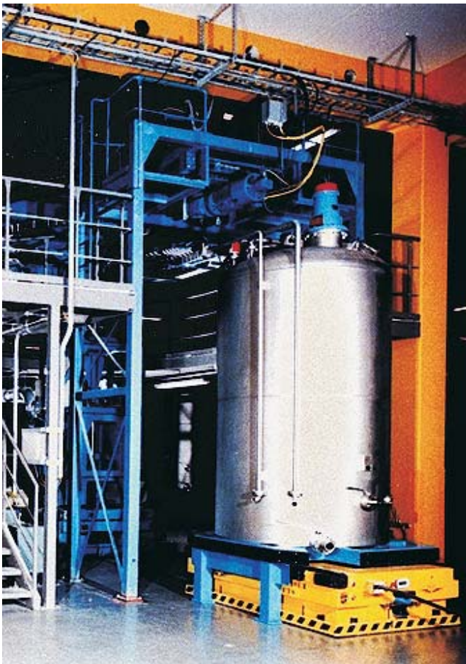
Abb. 1: Ein Mischerbehälter wird schwebend auf die Dosierstation transportiert
